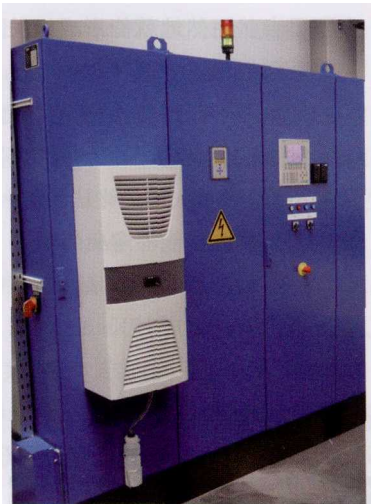
图4 电气柜控制着过滤设备的冷却液供应、清理和加热三大任务
