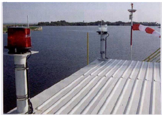
图 2 直升机停机坪的访问安全系统和视频监控系统：所有系统任务通过贝加莱的 X20 I/O 传送到控制器
