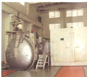
图8 线圈真空无溶剂浸渍系统
