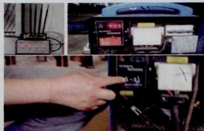
图2 山东奥太焊机群控管理系统
