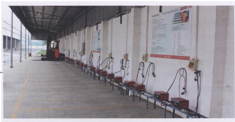
图5 专业的电瓶叉车充电站和专门的叉车维修区
