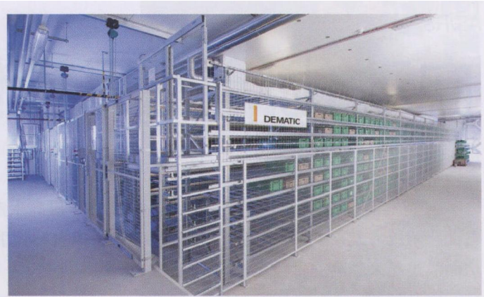
图 2 32 辆穿梭车在高架库内自动穿梭进行货物的出入库作业
