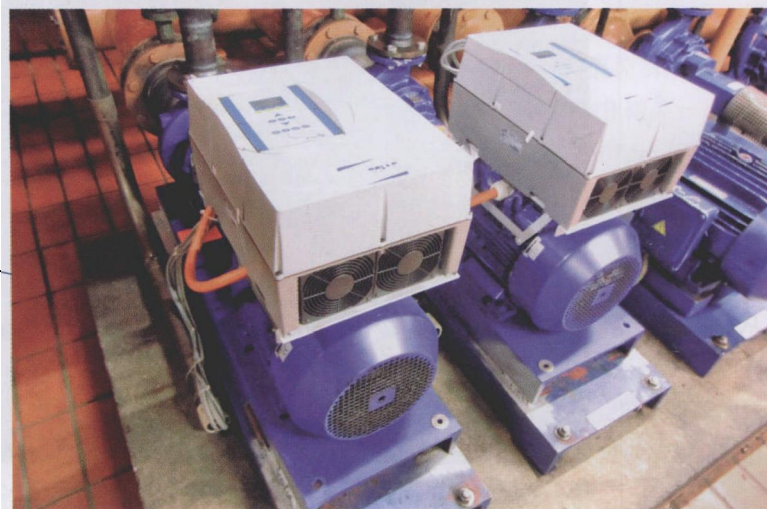
图3 流量减小后转速调节冷却泵驱动装置根据设定的理论压力值对泵的转速进行调节
