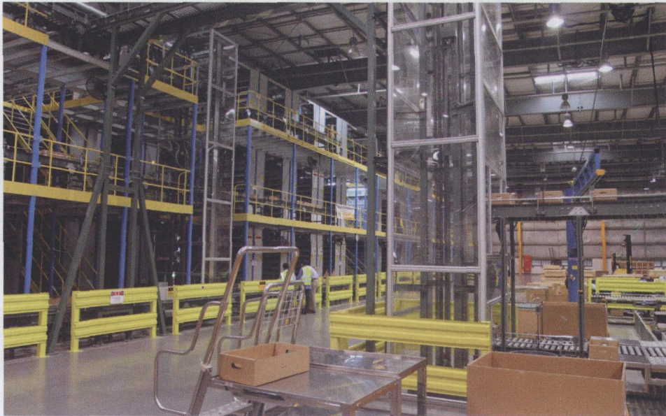
图3 垂直提升机单体
