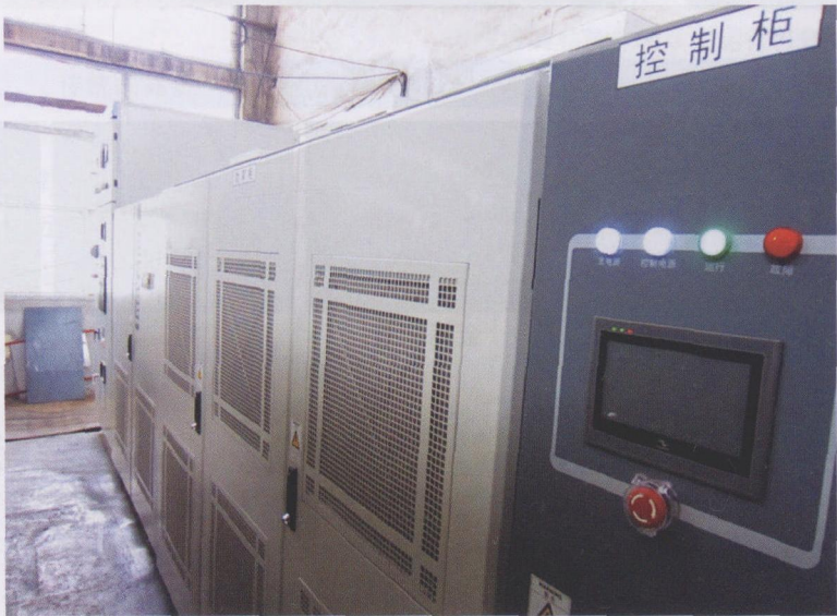
图 1 提升机现场变频器整机图
