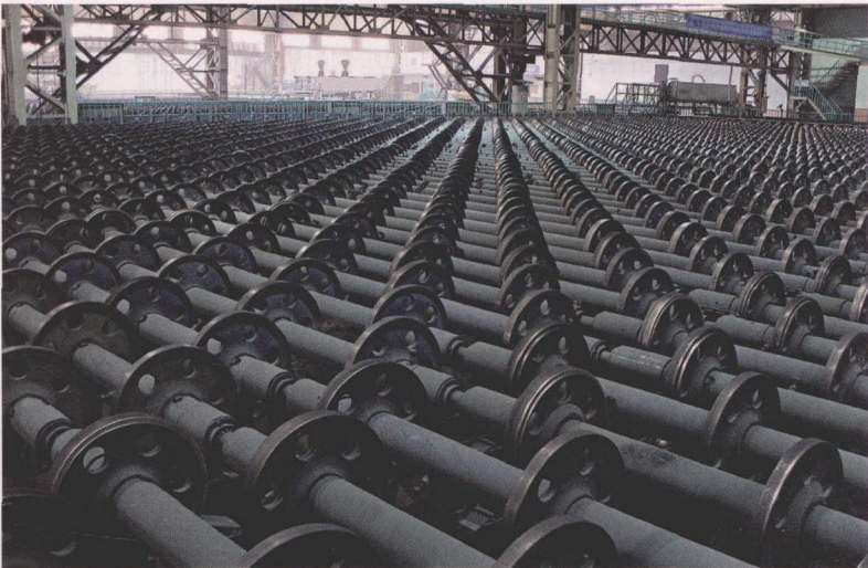
图 1 板材轧制生产过程中的冷却输送带通常要安装使用 5000 个轴承
