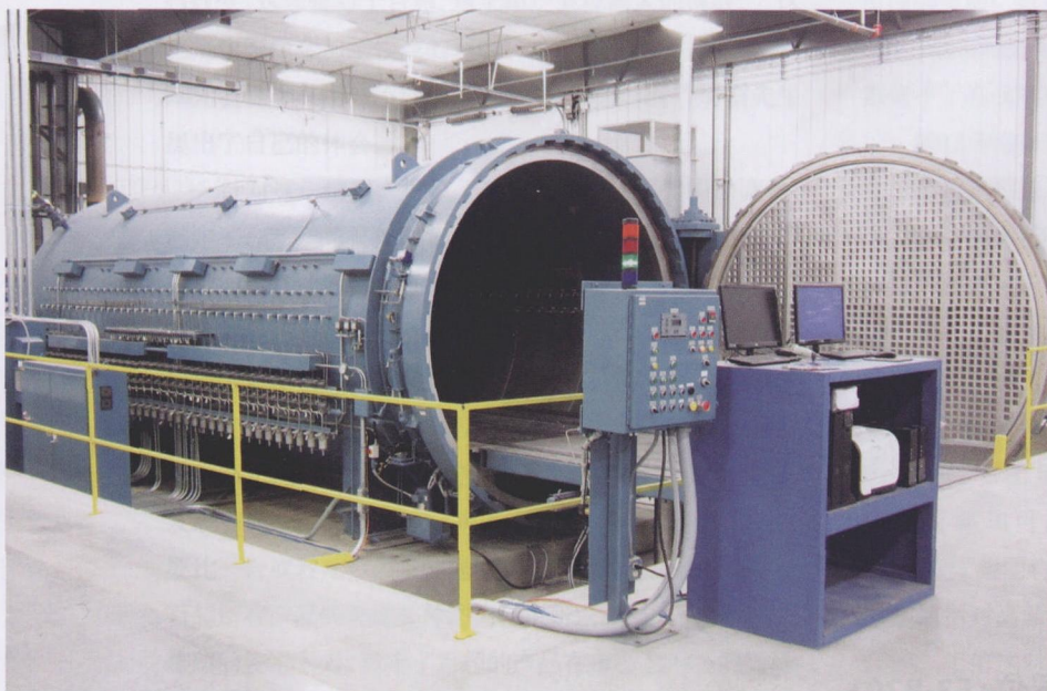
图 1 支持 Royal 公司接纳更大组件加工的另一个关键是这个 ASC Process Systems 出品的反应釜。这个最大的 ASC 高压釜可以安装在厂房里
