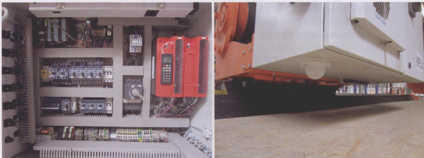
图2 电气控制柜中的无线通信模块(a)和电气柜底部的无线天线(b)
