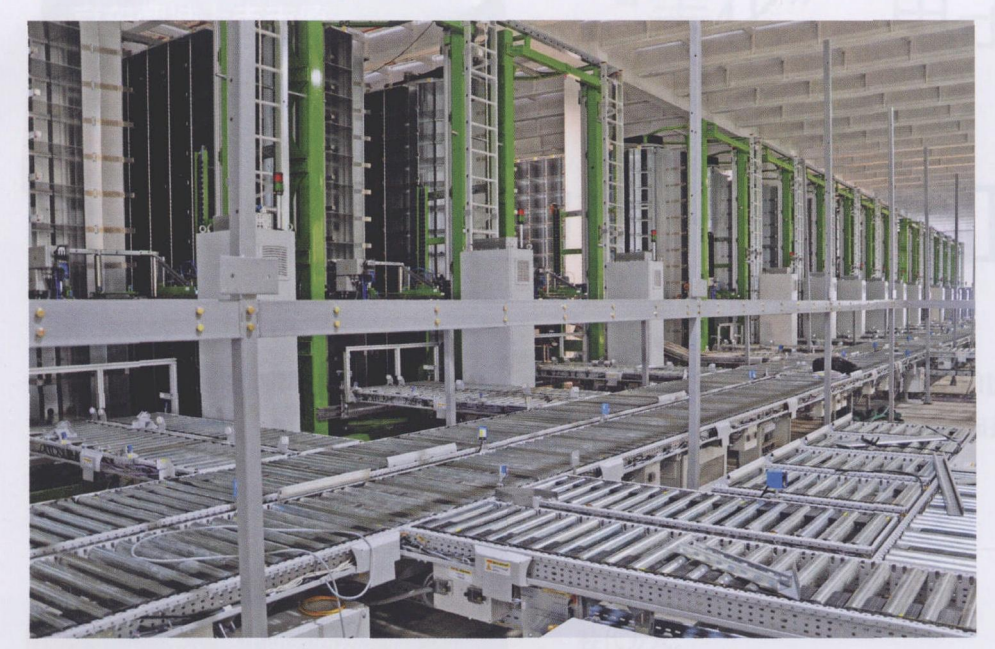
胜斐迩为上海杜隆实业建造了目前亚洲日订单处理能力最强的自动化物流配送中心
