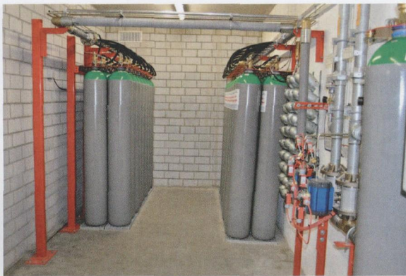
图4 创新的防火：气体灭火装置配备有特殊的火警报警系统，以保护组装缓冲存储仓库系统和库存组件
