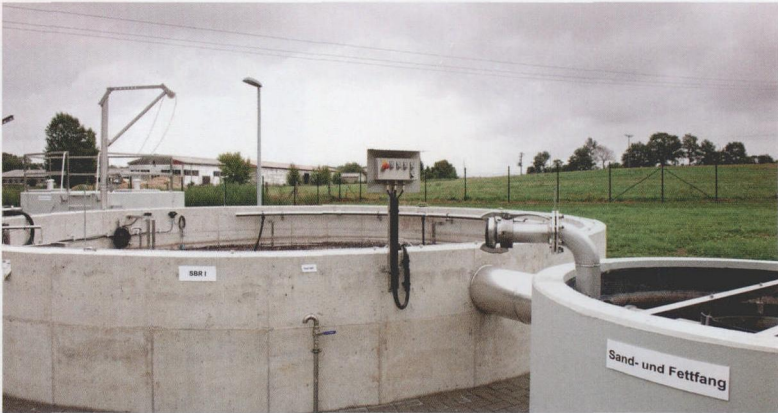
图2 装有工业控制装置的污水处理厂实现了高度标准化。这些污水处理厂之间的区别仅在于污水处理厂的建设规模大小的不同。即沉淀池、使用的泵组、曝气装置的个数不同，以及池中污水贮水量的不同。图中展示的是德国萨克森安哈特州的 Bornsen 污水处理厂
