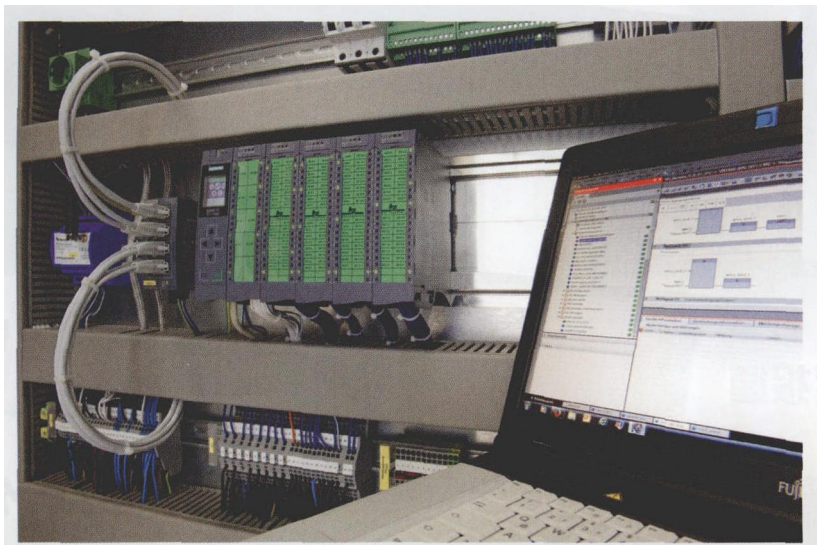
图1 运行顺畅的全集成自动化（TIA）净化污水排出口可以节省工程技术的投入，因为各种不同的控制装置只需要一个结构件文库进行维护
