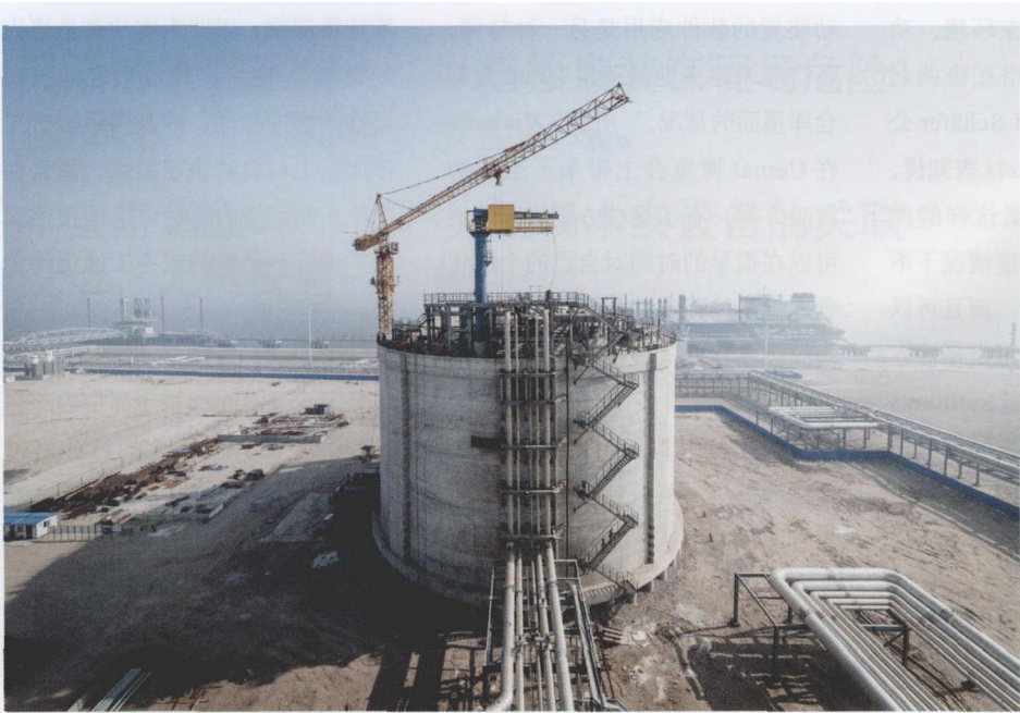
图 2 一台用于维护的起重机安装在 40m 高的液化天然气罐顶部，用于将液化天然气中的泵从罐中提升起来。柱形悬臂式起重机经常被用于 LNG 罐顶，将位于悬臂覆盖半径范围内的部件吊起
