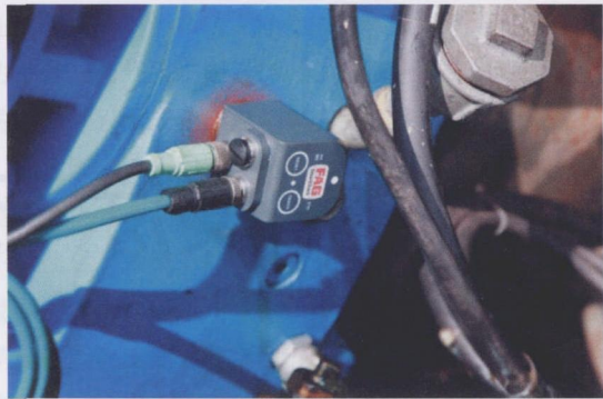
图3 某污水处理厂使用3个FAG SmartCheck设备测量螺杆泵的齿轮振动
