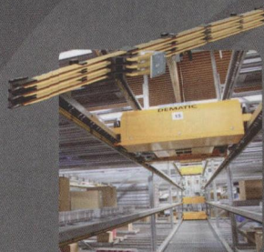
滑触线产品 为高架库穿梭车供电
