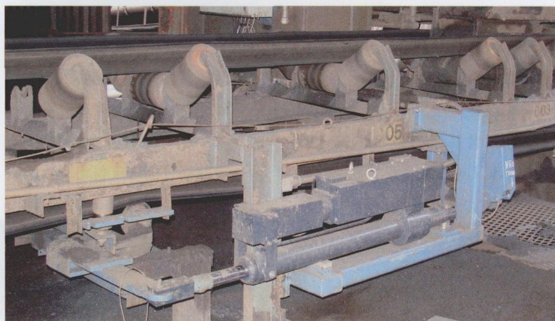
图3 HKAL 系列紧凑型液压驱动单元在恶劣的环境中保证了巴西某露天矿山输送带的正常工作
