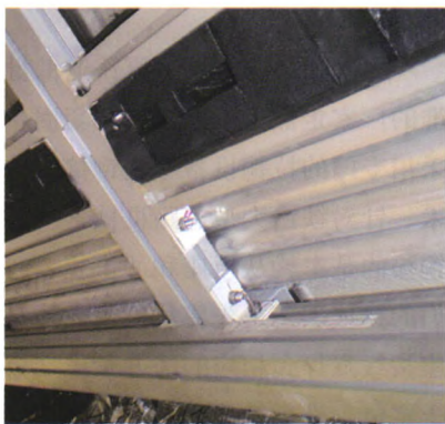
图7 成都地铁线槽布置
