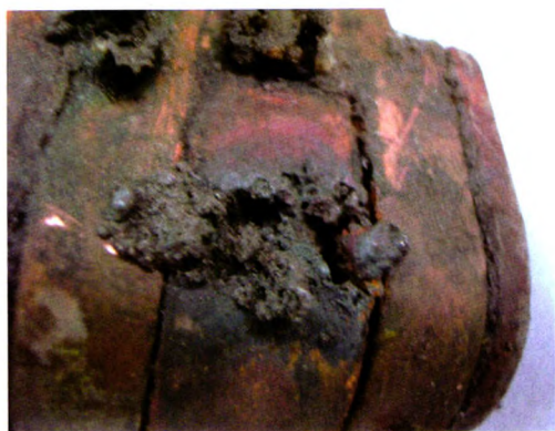
(a) 电击穿实例(中间是电击穿烧坏的可加工导磁体,上下是通水铜管)
