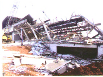
图2 主体钢结构“坍塌”现场
