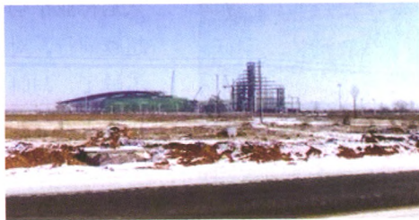
图1 主体钢结构“坍塌”全景
