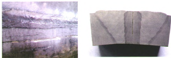
图7 BOX结构上“层状撕裂”图8 节点设计不合理造成“层状撕裂”（工程实体试样）
