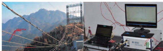
图 4 覆冰试验场试验 OPGW 光缆及分布式温度监测系统
