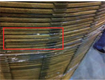
图 3 C 相高压线圈检查情况
