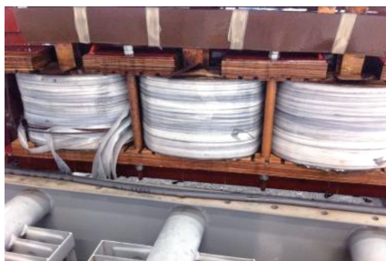
图3 变压器C线圈绑带破损
