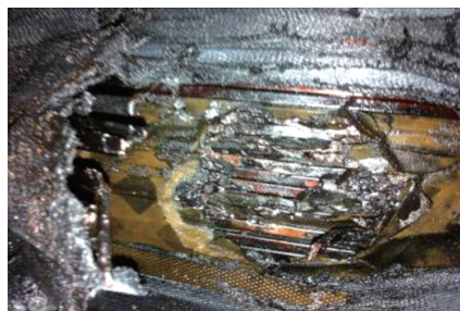
图5 C相高压线圈故障程度
