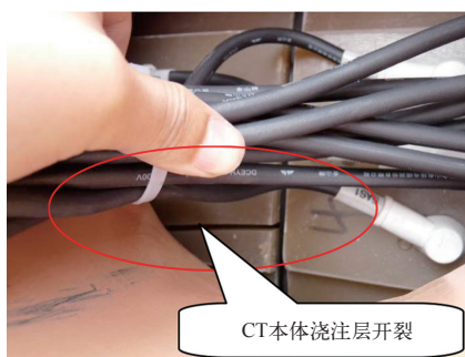
图3 CT线圈本体浇注层开裂实物图
