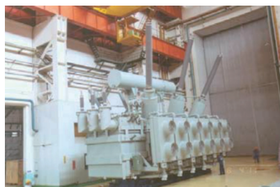
图10 福州北变电站500 kV变压器套管 应用复合绝缘子
