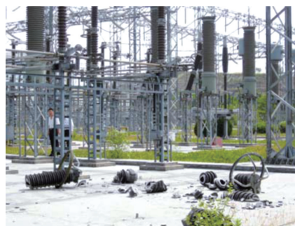
图1 汶川震后某变电站瓷和复合绝缘子受损情况
