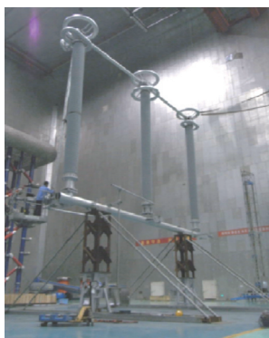
图4 750 kV交流隔离开关
