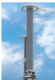
图6 500 kV母线 复合支柱绝缘子
