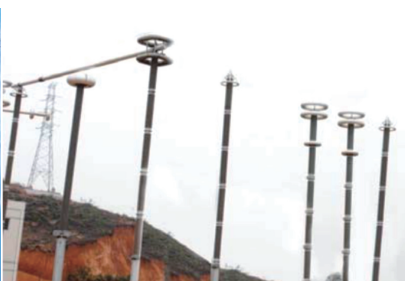
图7 ±800 kV云南—广东直流工程 母线复合支柱绝缘子
