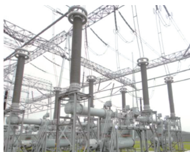
图8 石钟山变电站500 kV GIS
