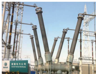
图9 新疆乌北变电站750 kV罐式断路器
