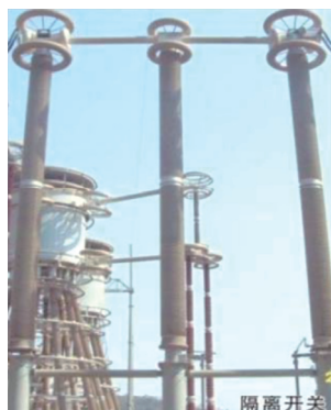
图5 ±800 kV云南—广东 直流工程复合隔离开关
