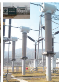
图11 鹤龄变电站 500 kV电流互感器
