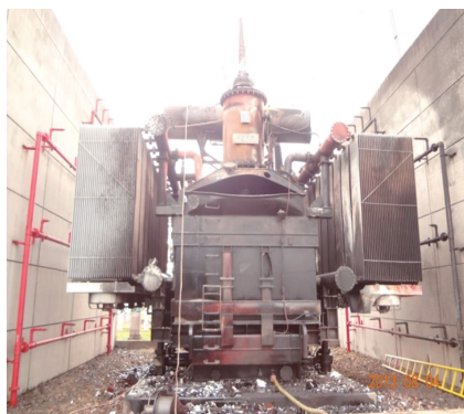
图1 故障变压器箱体
