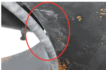
图3 升高座底部的油箱内壁放电点
