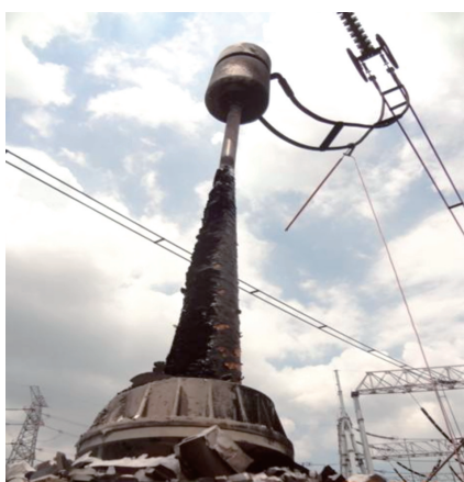
图2 故障变压器变高侧套管
