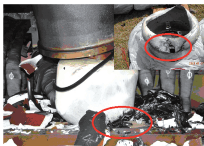
图4 均压罩的放电烧穿孔
