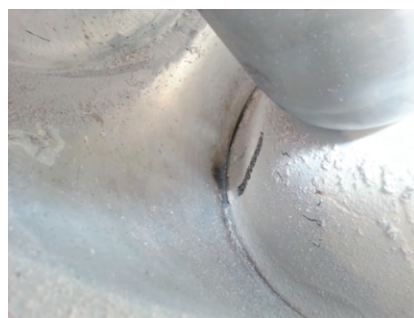
图3 故障气室内部实物图
