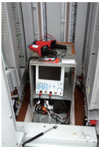
图1 放置在汇控柜内的测量系统
