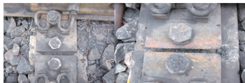
图3 正常的道岔扣板 图4 烧蚀的道岔扣板
