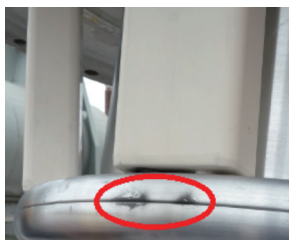
图11 底部均压环缝隙 放电痕迹
