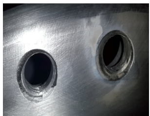
图12 均压环螺孔 放电痕迹
