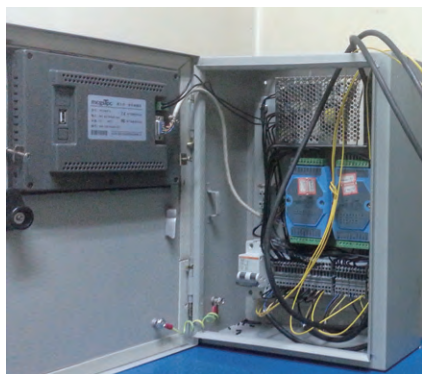
图6 调试过程中的新信号转换箱
