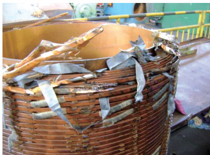
图1 变压器线圈烧坏侧面
