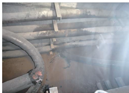
图2 6 # 电容器组电缆沟内电缆中间部位烧断
