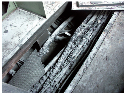
图3 电缆故障烧毁情况
