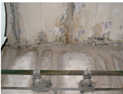
图4 1#主变压器电抗器室内雨水渗漏情况
