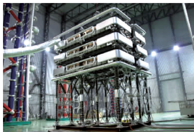
图6 1 000 MW/ \pm 320 kV柔性直流换流阀
