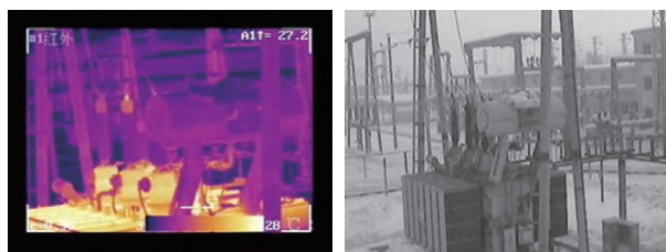
图2 变电站设备图像
