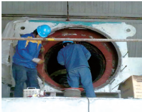
图5 现场增压风机试验照片
