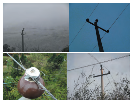
图2 配网线路雷击故障现场典型图片
