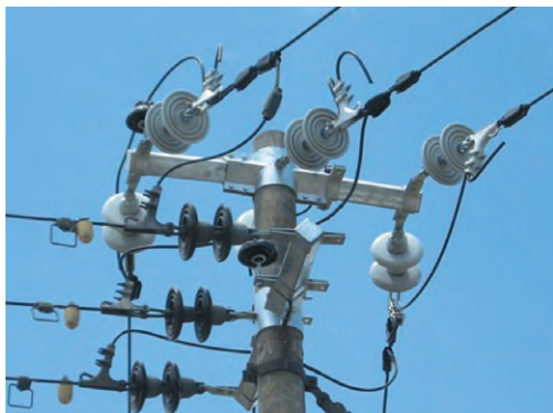
图4 双担改单担、平放改斜放的横担照片
