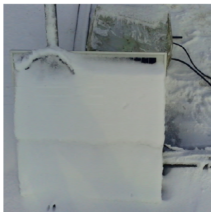
(a) 太阳能供电系统覆雪现场图
