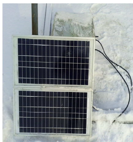
(b) 太阳能供电系统融雪现场图
