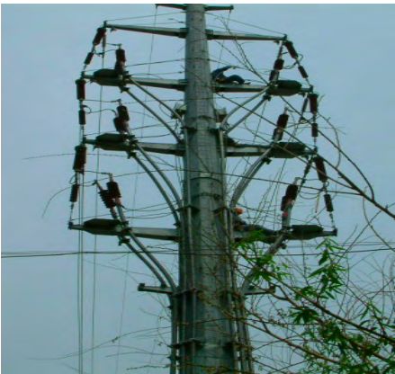
图 1 电缆终端避雷器现场图
