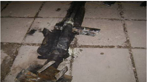
(b) 第二次击穿金属金属铠装以及铜带腐蚀
