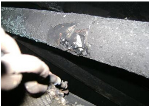
(e) 第一次击穿旺桥一故障对旺桥二外护套损坏
