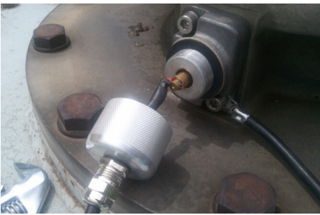
图8 现场末屏安装实物
