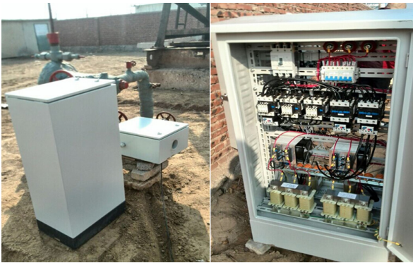
图10 抽油机能效控制系统现场
