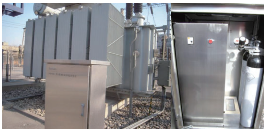
图3 变压器油温及气体监测模块现场照片
