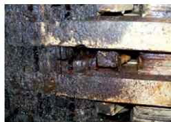
图3 定子铁心烧损情况
