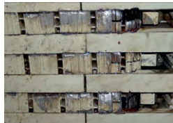
图5 定子铁心损伤严重
