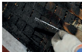
图4 脱落的通风道工字钢
