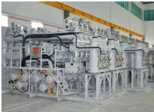
图3 产品现场运行照片
