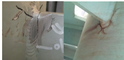
图11 拉杆波纹管应用于户外站时出现的支撑开裂
