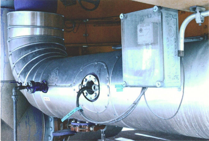
图 3 安装在蒸发器设备和结晶器装置上的测量系统与当地使用条件进行匹配，该使用场所为制糖企业
