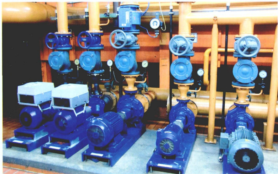
图3 在许多液体循环系统中，泵主要是在部分负载工况下运行。而驱动泵的异步电动机则常常是最佳工作区间外低效运行
